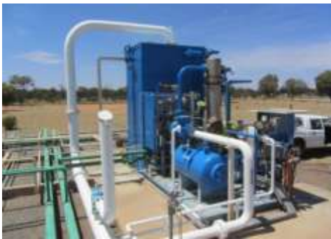
Alice Spring LNG Plant
