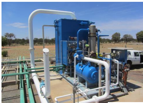
Alice Spring LNG Plant
