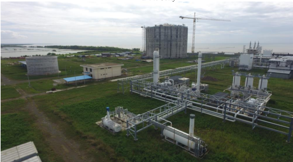
Sengkang LNG Plant
