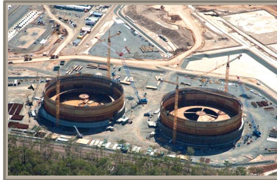
LNG Tanks, January 2013
