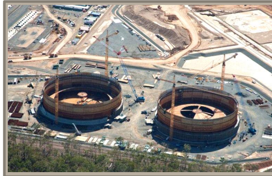
LNG Tanks, January 2013
