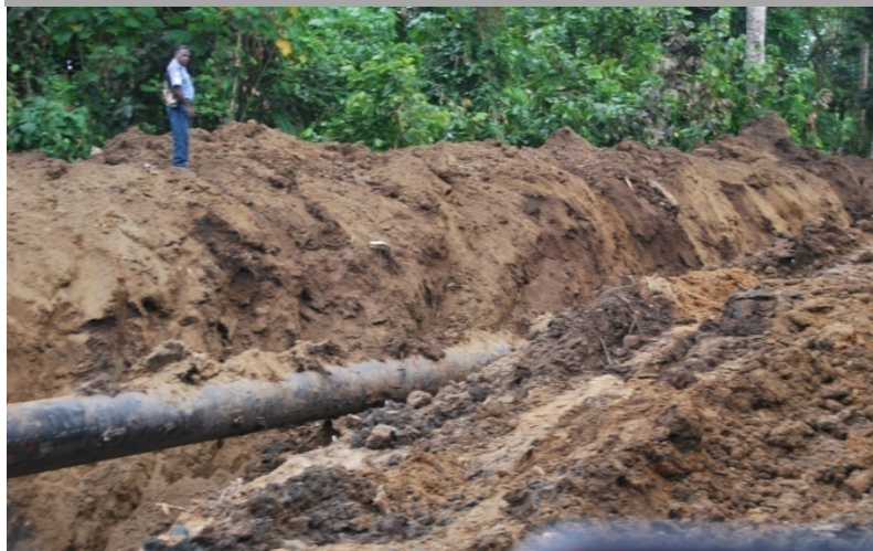
Slurry Pipeline - 135 km
